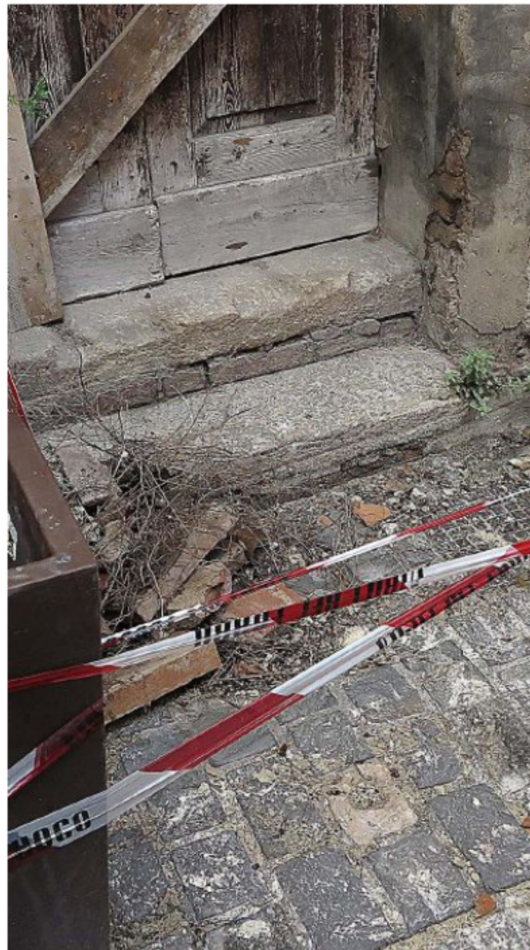
Il particolare di un edificio a rischio crollo in centro
